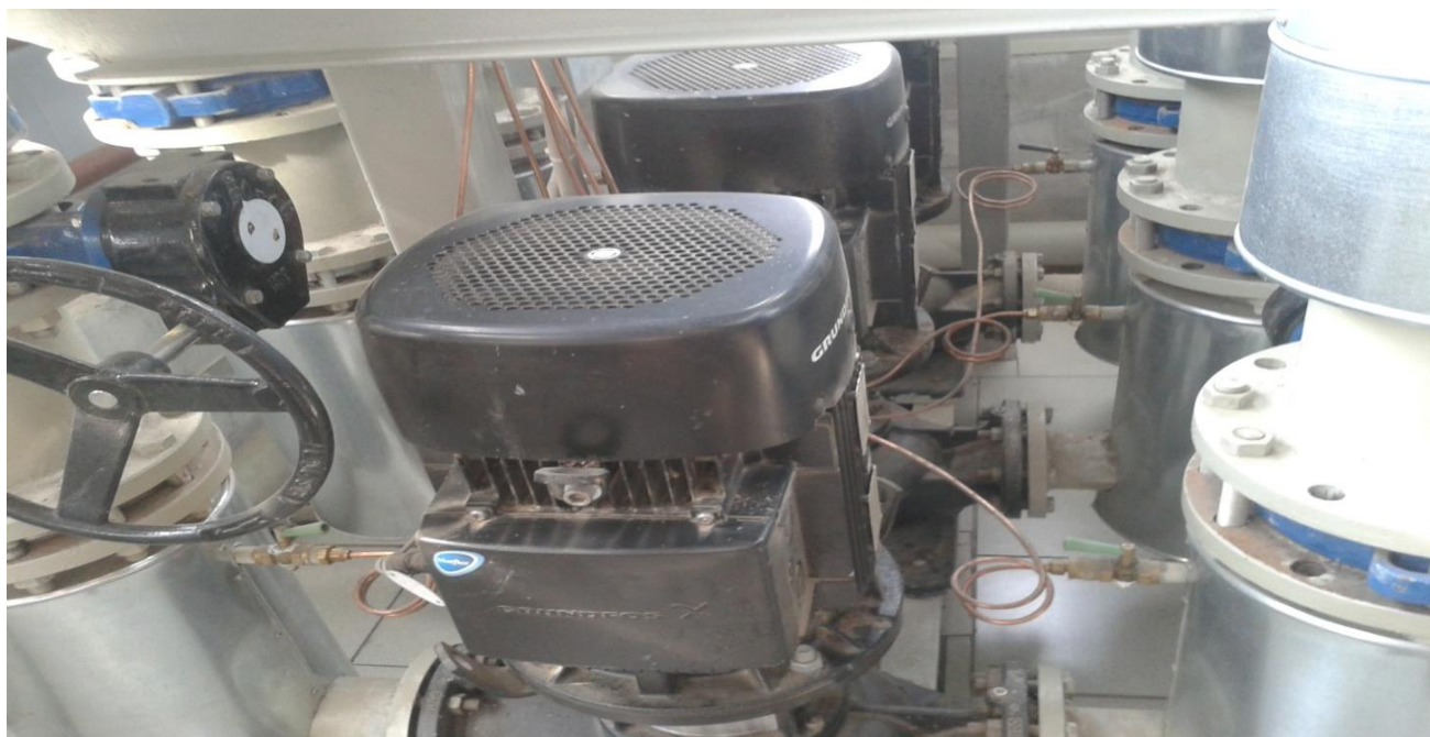
Рисунок 2.10. Насосное оборудование котельной.
