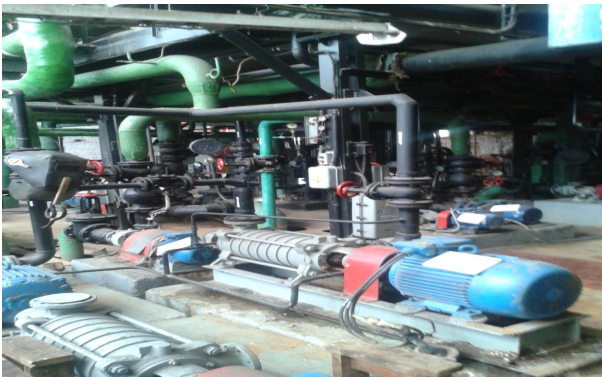
Рисунок 2.7. Насосное оборудование котельной.
