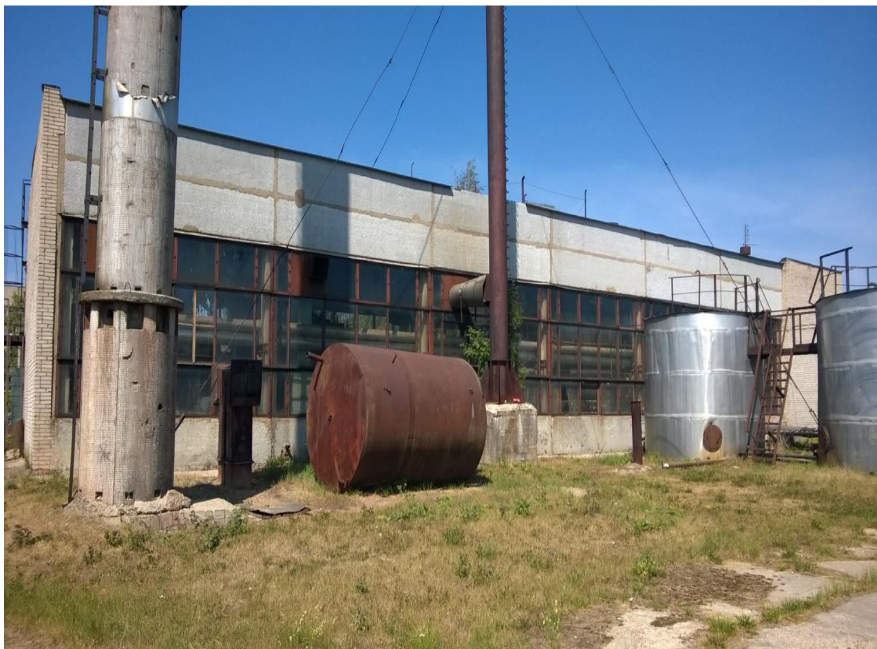
Рисунок 2.1. Общий вид котельной, расположенной в деревне Таширово.
