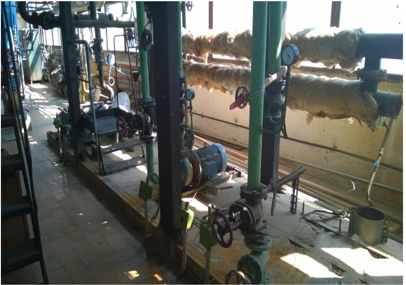
Рисунок 2.5. Насосное оборудование котельной.
