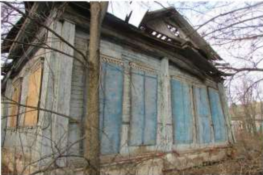
Рисунок 6.14 Внешний вид нежилого здания
